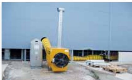
Warmfluterzeuger im Zuluftbetrieb
