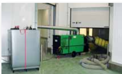
Warmfluterzeuger im Umluftbetrieb
