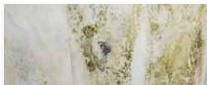
Schimmelbefall einer Hauswand
