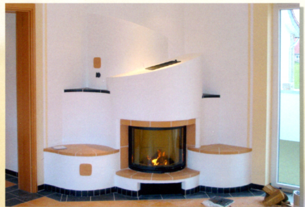
Heizkamin mit keramischen Rauchgaszügen
