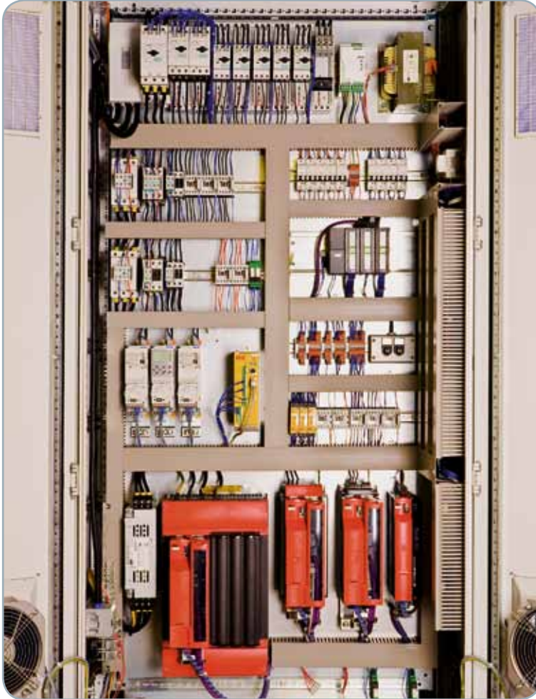
Schaltschrank für ein Regalfahrzeug
